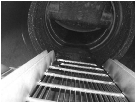
Gambar 4. Kondisi Kerusakan Sistem
