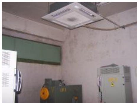
Gambar 3. Desain indoor di ruang mesin [2]
