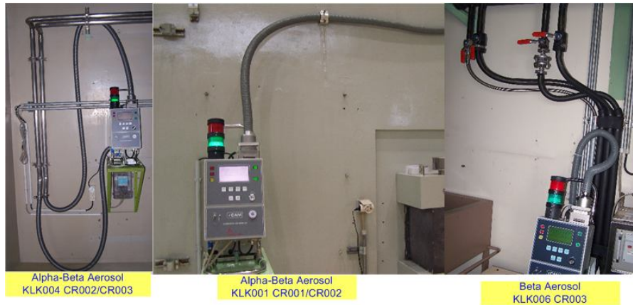
Gambar 6. Instalasi pengembangan jalur pencuplik udara
